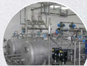
Liquid waste treatment 废液处理系统
